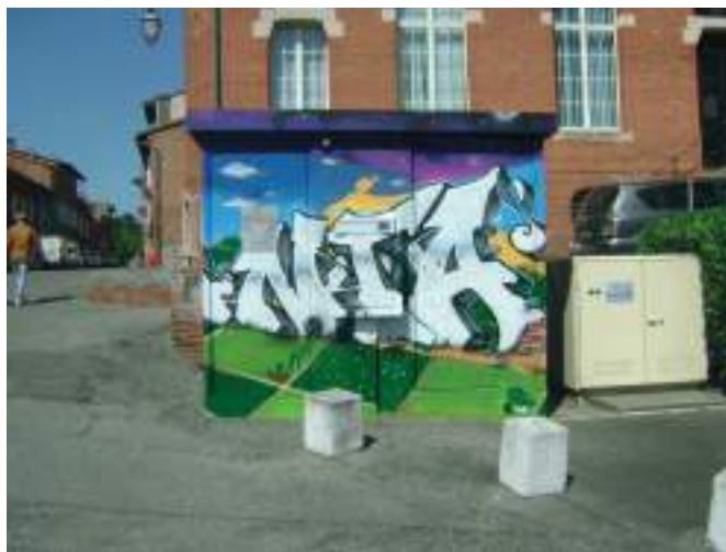
Graff d'Azek sur le transformateur de la
